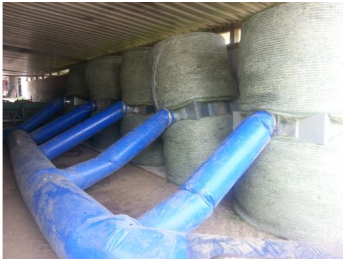
Einen Teil der Wärme nutzt Heiner Bucheli zur Heutrocknung.
